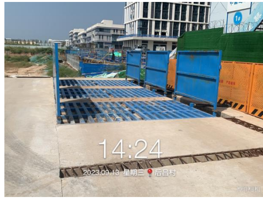
临时排水及洗车台
