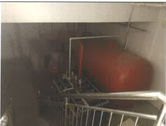
位于地下室的泵房
