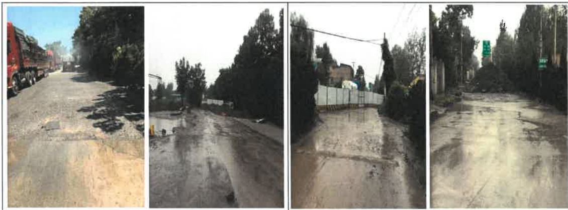
211 国道磨子桥段道路破损
