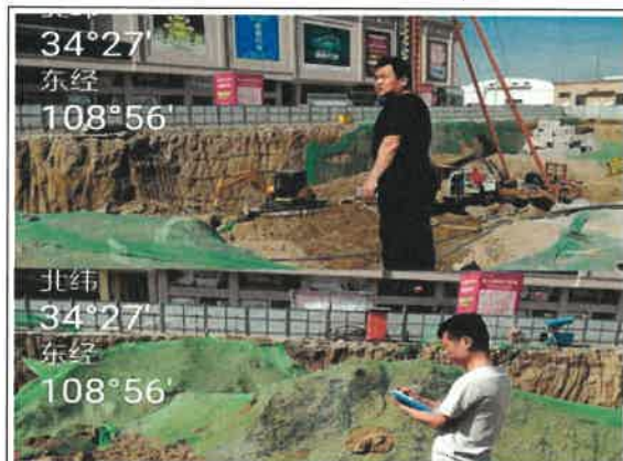
部分黄土未覆盖，降尘措施不到位
